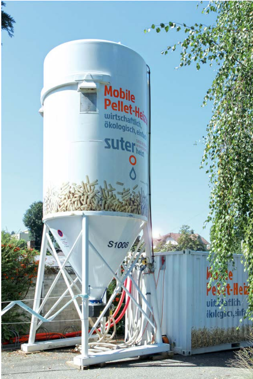
Die Retter in der Not: Zwei modulierende Heisswasserkessel à je 140 kW Leistung sowie ein Silo mit 14 t Pellets.
